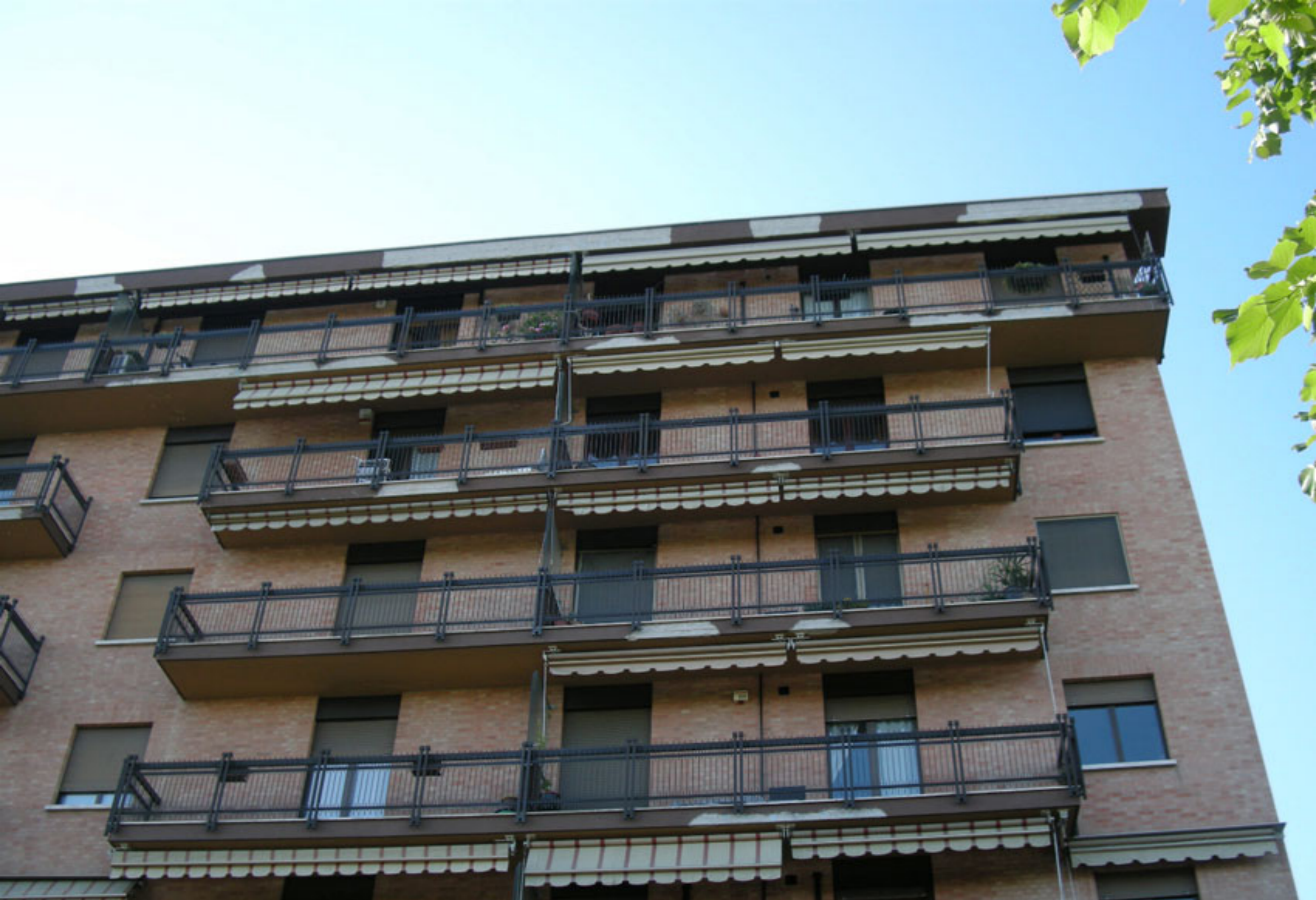
Vista della facciata con elementi ammalorati
