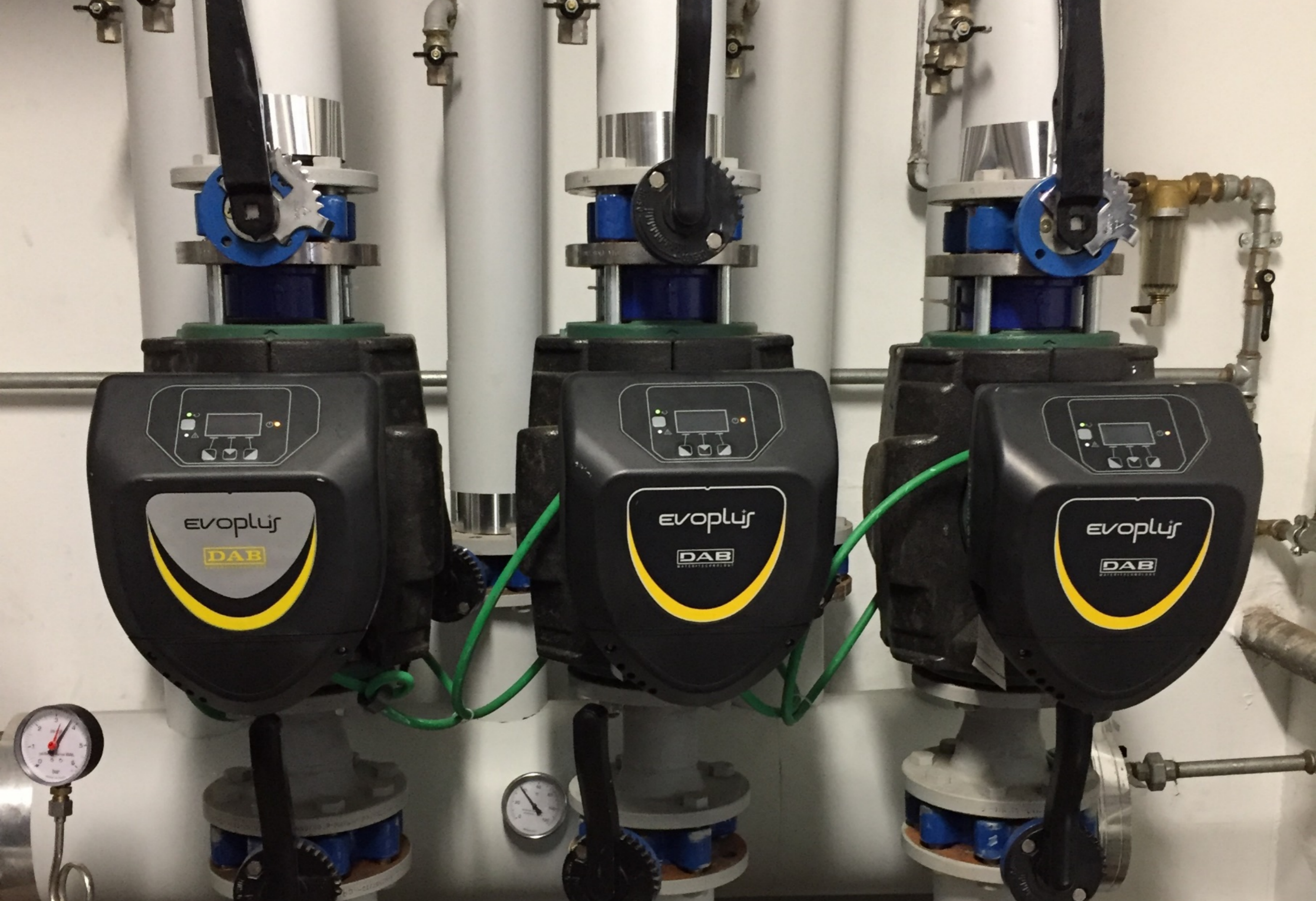
Particolare circolatori impianto secondario
