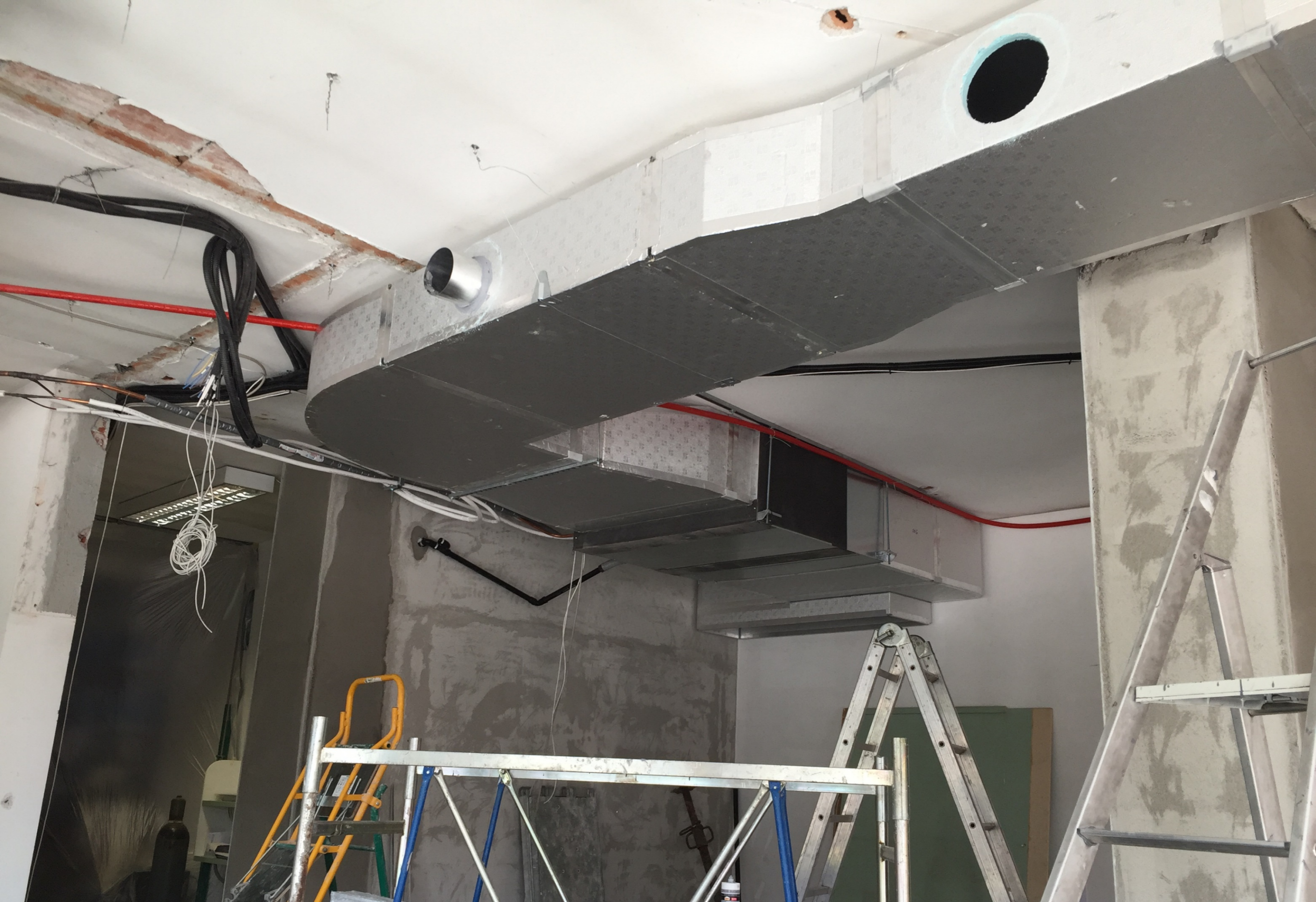
Dettaglio impianto di climatizzazione estiva e invernale
